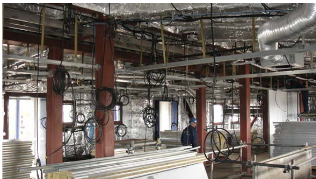
MAIN SWITCH ROOM 内部
