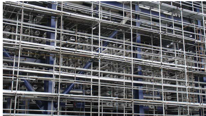
海水淡化RO模块外部
